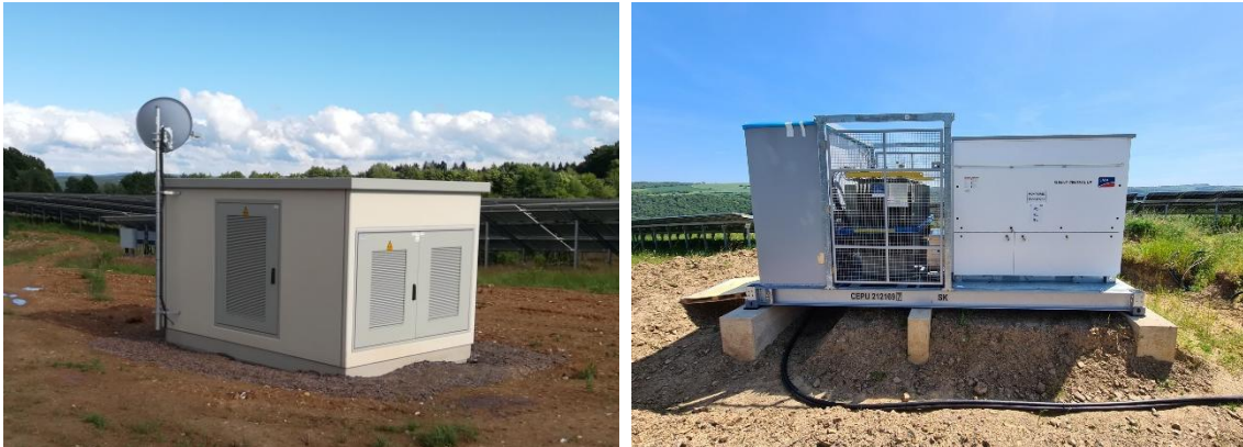
Abb. 3: Beispielhafte Trafostation als Kompaktstation auf einer Freiflächenanlage (links) und Kombistation mit Trafo, Wechselrichter und Schaltanlage auf Streifenfundamenten (rechts) (Fotos: BGHplan)
