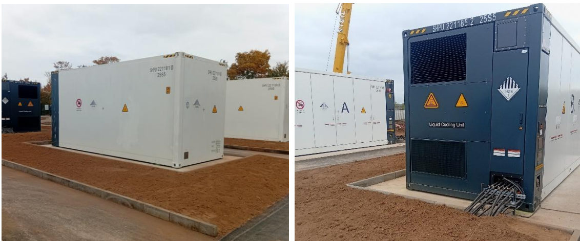
Abb. 4: Beispielhafter Batteriespeicher als Container auf einer befestigten Bodenplatte
